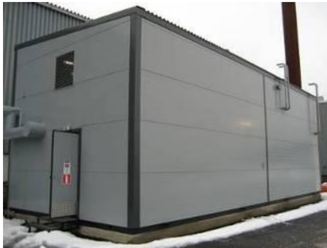
Siirrettäviä vesi- ja höyrykattilalaitoksia voi myös vuokrata. Kuvassa Höyrytys Oy:n kontti.
