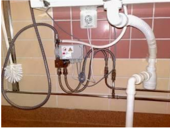
Tampereen TAYS:n uuden silmäkeskuksen potilashuoneen suihku/WC-tilan asennuksia 2010-luvulla. Lavuaarin viemäri tulee lattialle ja kuvan ulkopuolella oleva pönttö on sekin asennettu lattialle. (BHa)
