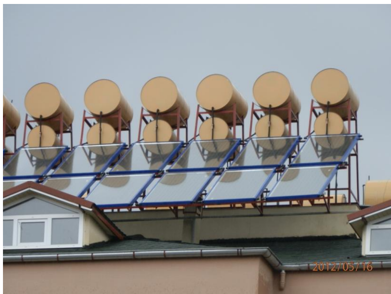
Tasokeräinpatteristo erillisine vesisäiliöineen Alanyassa Turkissa. Valok. Pirkko Rantanen.
