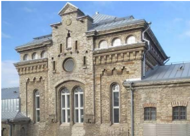
Vanhojen suojeltujen arvorakennusten korjaaminen ja saneeraaminen on oma taiteen lajinsa. Tässä vanha pyöreä ikkuna on otettu tuloilman käyttöön. (BHa)
